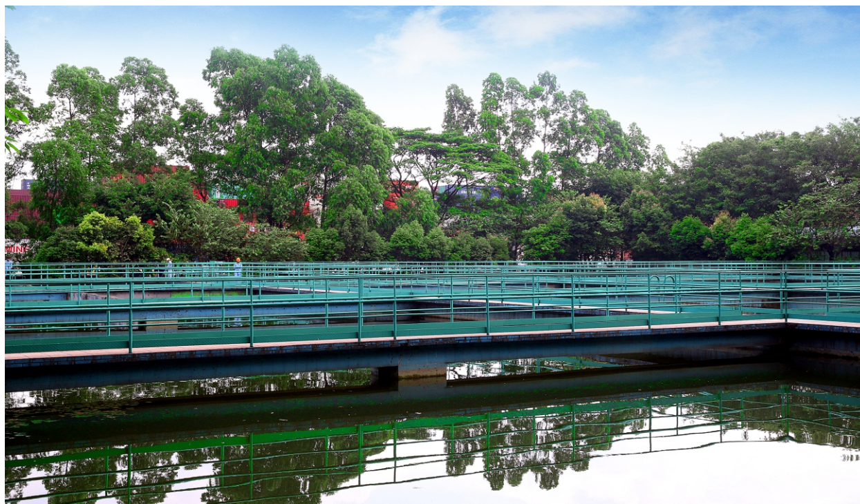
绿树成荫的工业净化水珠江排放口储存池
