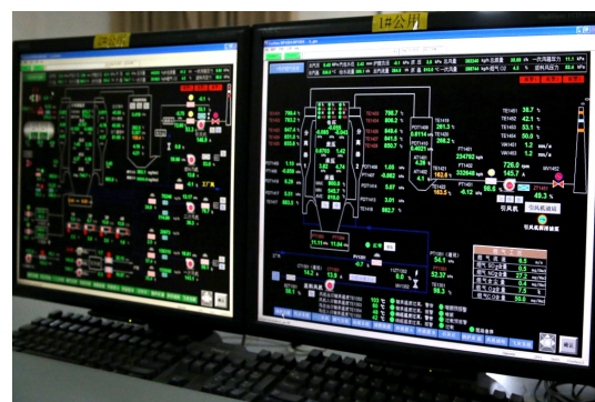
锅炉烟气排放情况在线监控，并与地方环保部门在线联网
