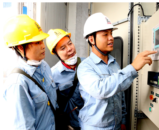
锅炉操作人员进行操作
