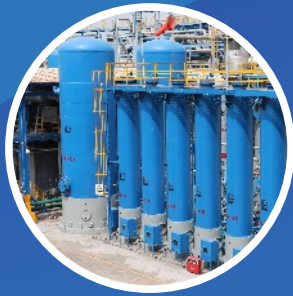
② 变压吸附提纯工序(PSA) 提纯氢气 氢纯度99.999%
