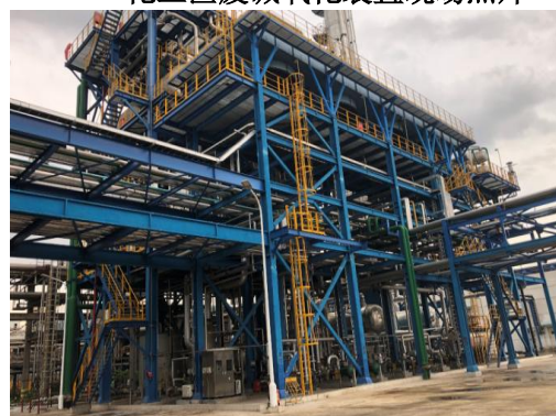
污水汽提装置现场照片
