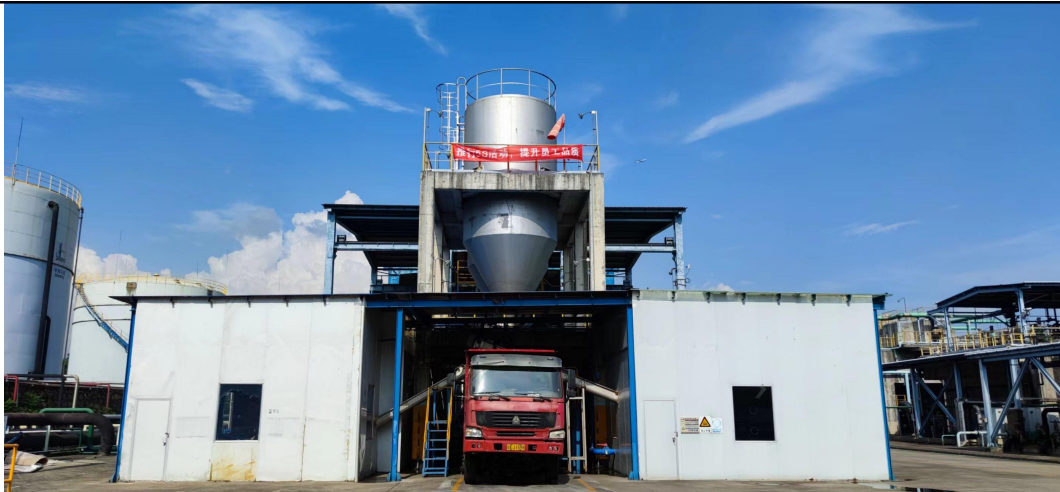
污泥干化设施现场照片
