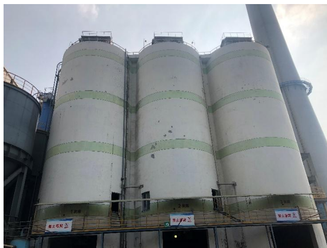
CFB 锅炉炉渣、炉灰贮存库现场照片
