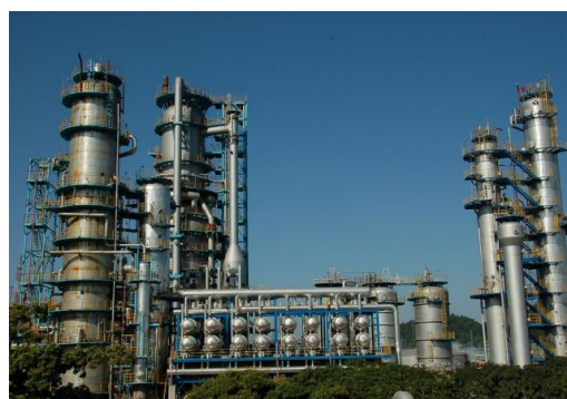
蜡油催化裂化装置利用现场照片
