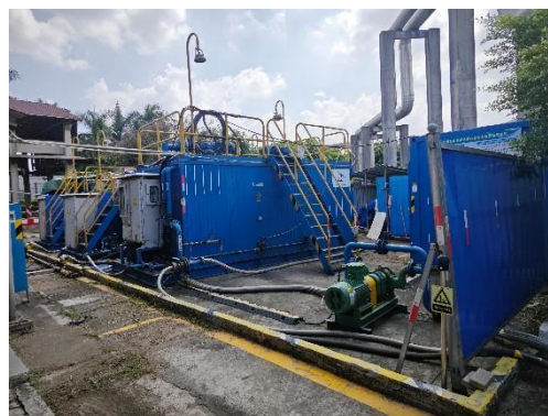
清罐污油三相分离设施现场照片
