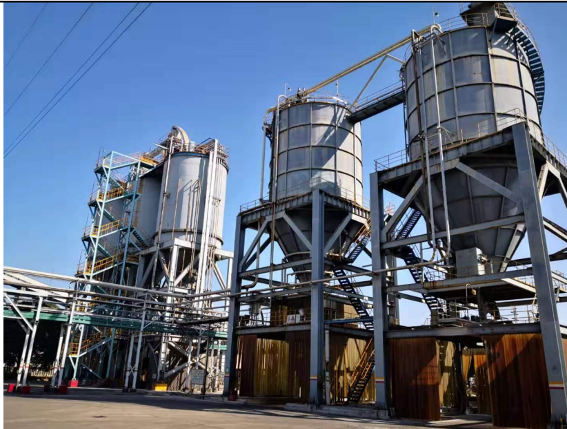
粉煤灰灰库及输送与分选系统现场照片
