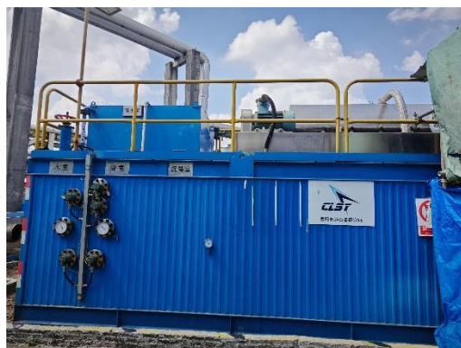
清罐污油三相分离设施现场照片
