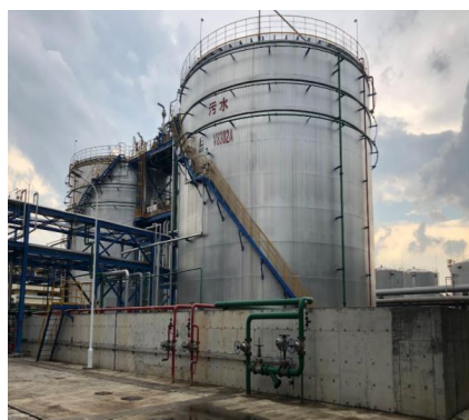
化工废碱液进污水汽提储罐现场照片
