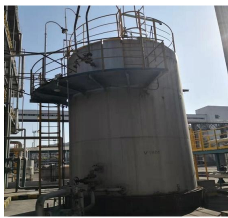
污油进装置前进料罐现场照片
