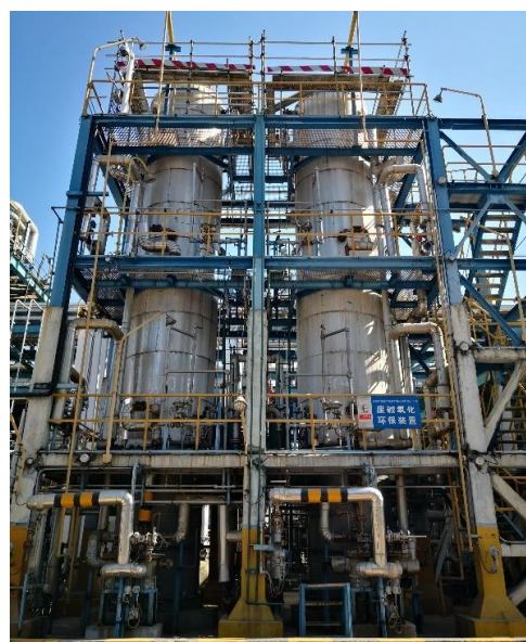
化工区废碱氧化装置现场照片
