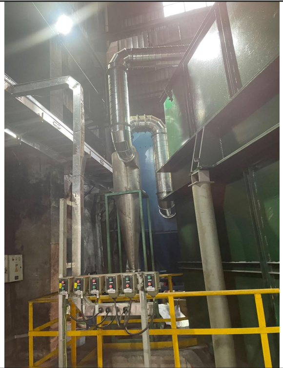
炉渣漏斗池废气处理 旋风除尘器
