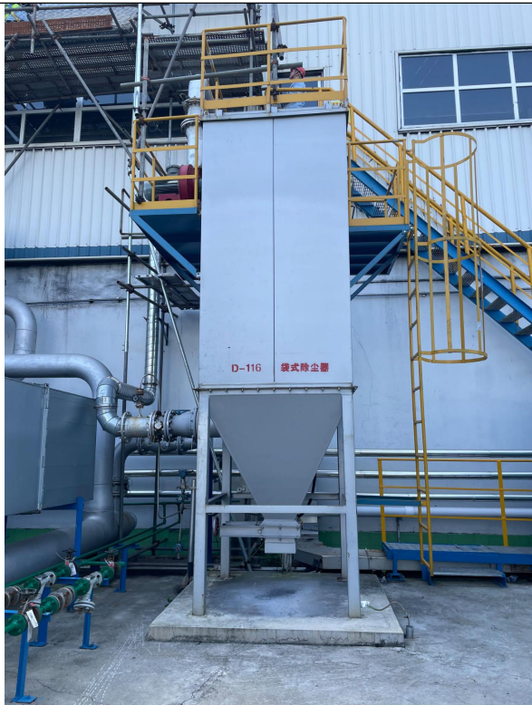
主搅拌机废气处理 布袋除尘器 (D-116)
