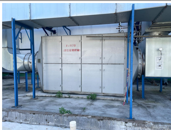
厂房整体收集废气处理 活性炭吸附装置 (F-117B)
