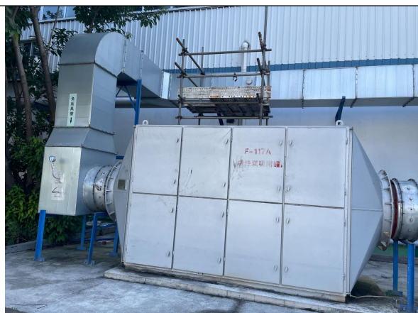
厂房整体收集废气处理 活性炭吸附装置 (F-117A)
