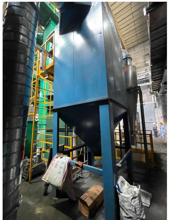
炉渣漏斗池废气处理 布袋除尘器 (D-117)
