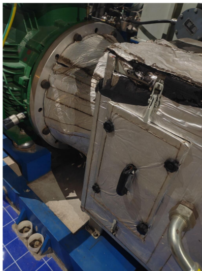
图3-3 隔声罩、基础减振措施现场照片
