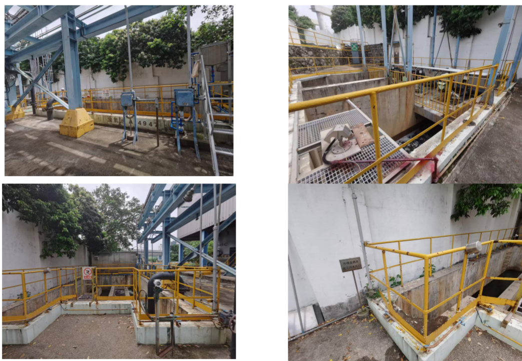
图3-2 化工区污水处理场现场照片
